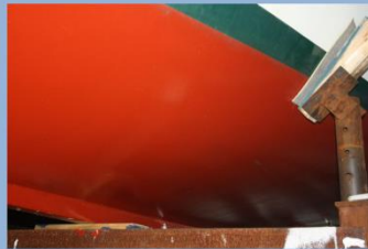
Nach Reinigung mit Wasser
